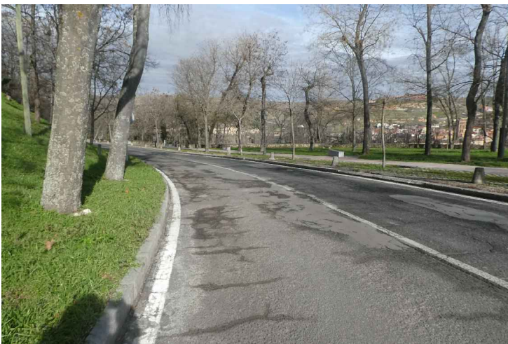
PK 0+350. ESTADO DEL FIRME
