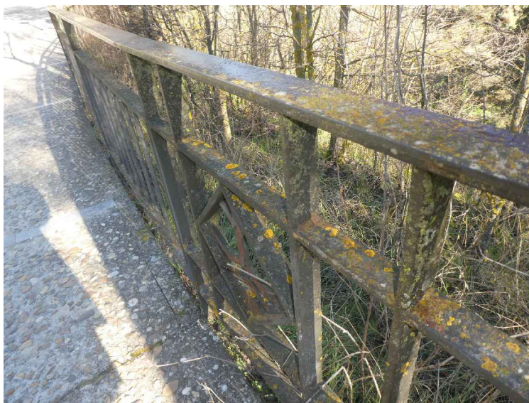
BARANDILLA EN MAL ESTADO
