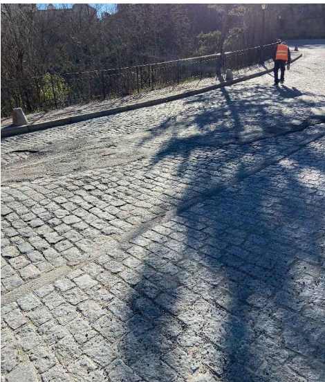
ESTADO DEL ADOQUÍN
